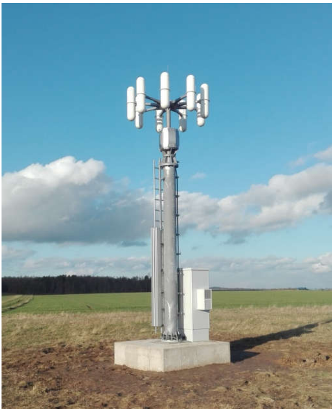
Feldinstallation des IZT R5509 Peilers in Calden.
